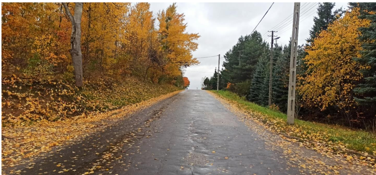
Fotografia 1 ul. Kościelna, na której brakuje chodników
