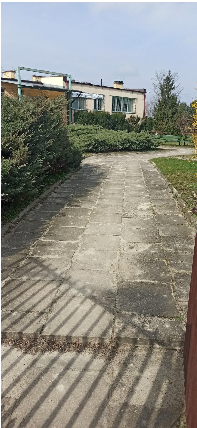
Fotografia 54 Chodnik za furtką, wraz z widocznym progiem
