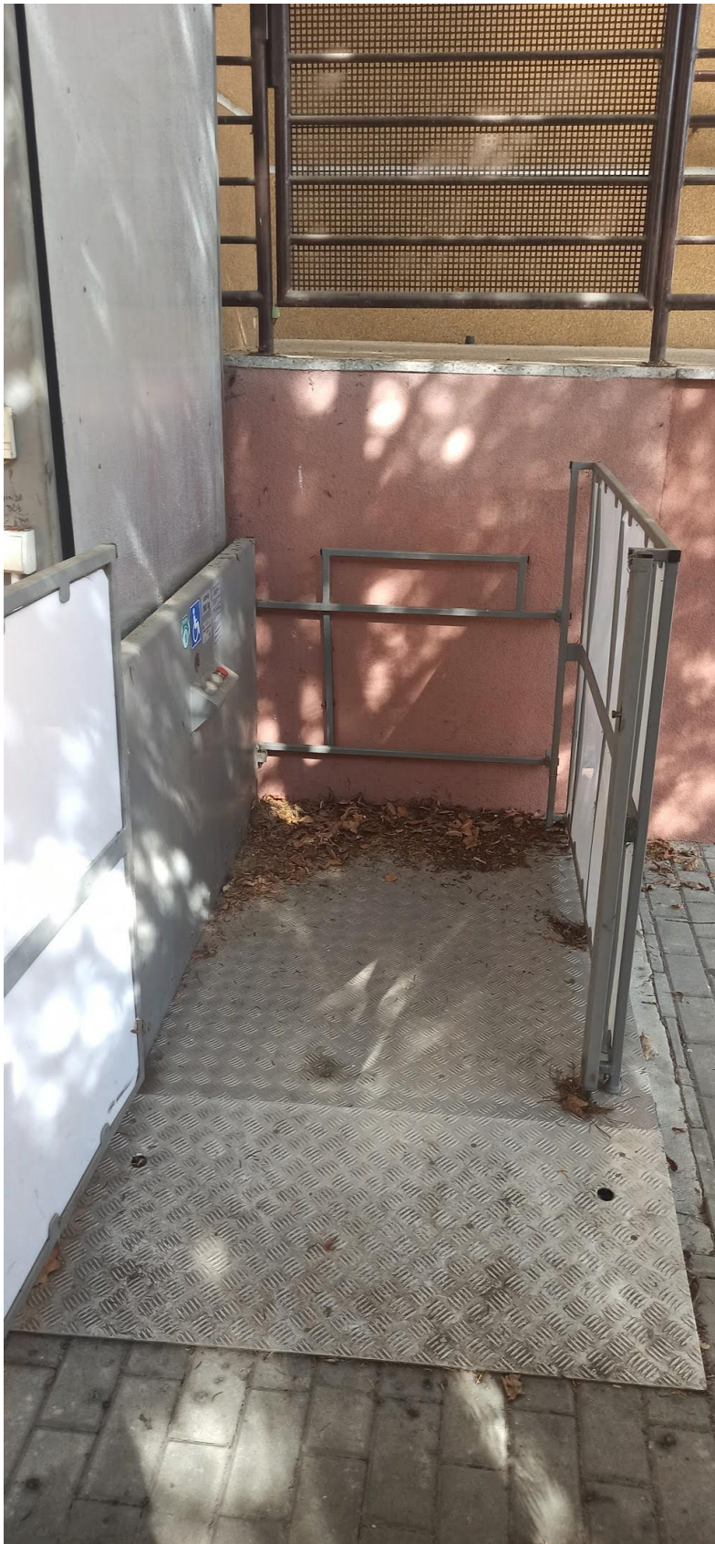
Fotografia 63 Winda dla niepełnosprawnych
