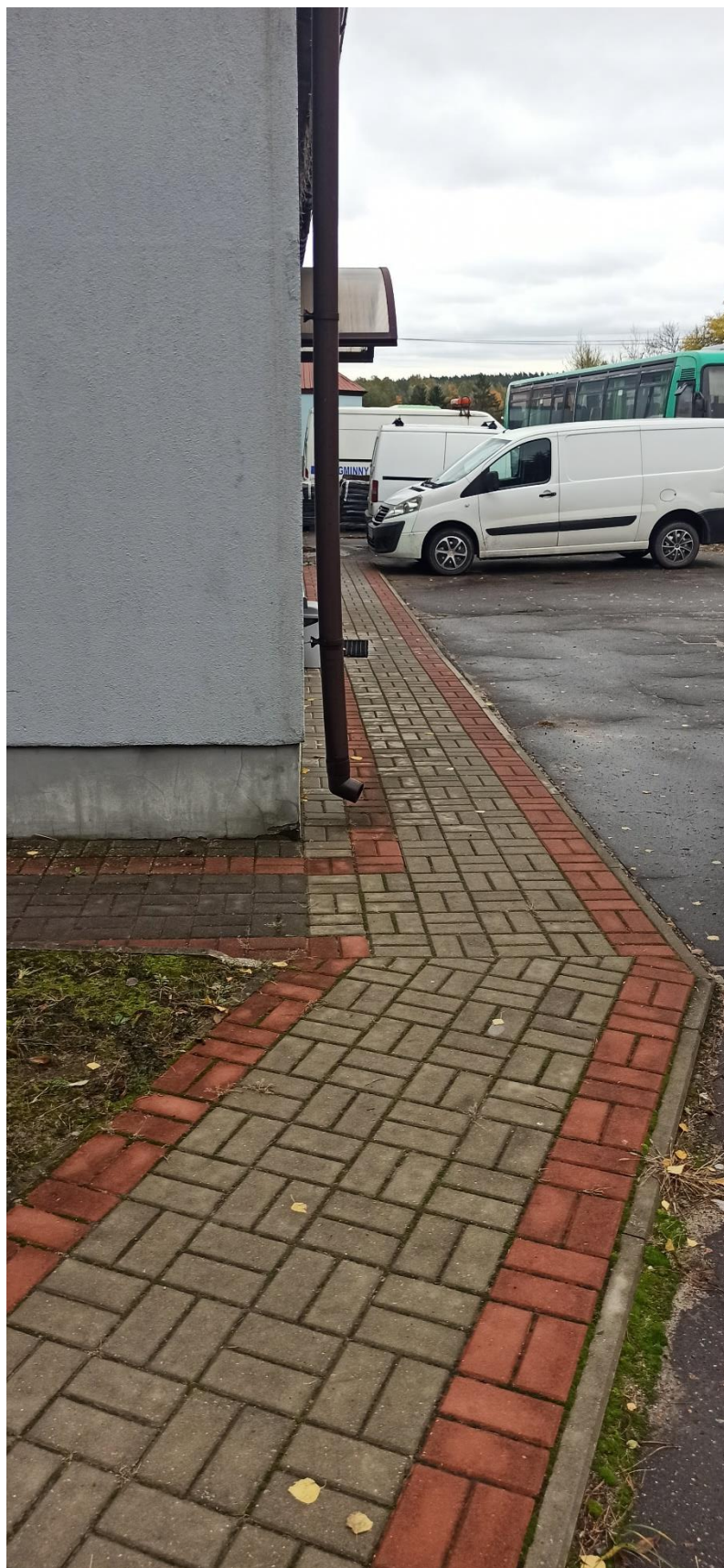
Fotografia 10 Fotografia 7 Chodnik prowadzący do głównego wejścia wraz z utrudniającą poruszanie się rynną
