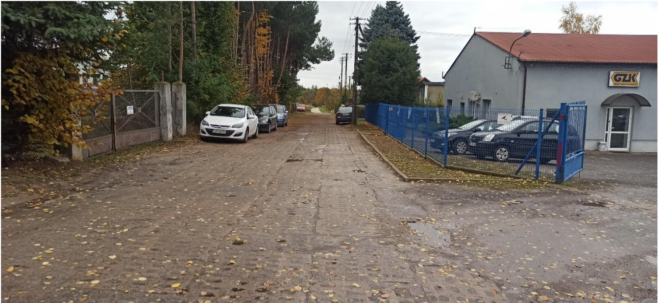
Fotografia 2 ul. Barbary Kaczmarek, wyłożona z nierównych płyt betonowych, bez chodników
